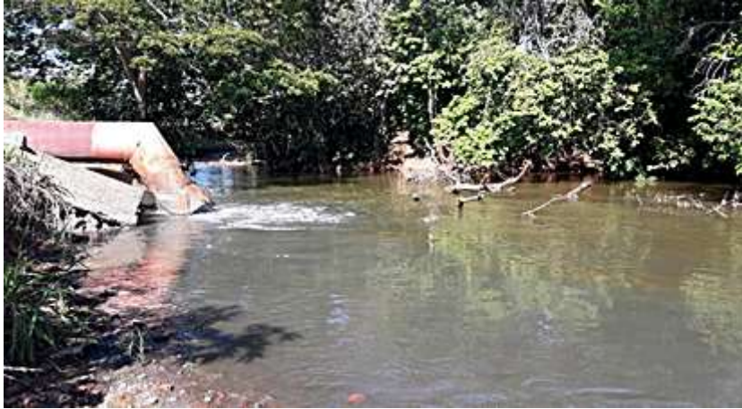
Figura 3. Lançamento de esgoto urbano, no leito do rio Lontra, centro de Araguaína/TO.
